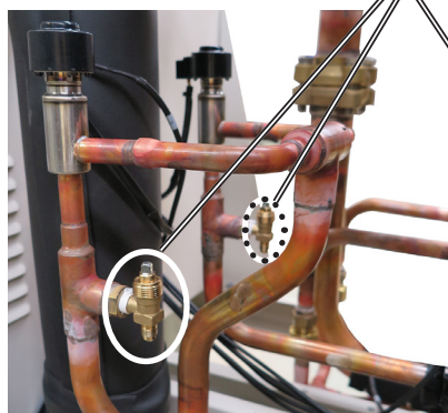
Aux soupapes de sécurité
